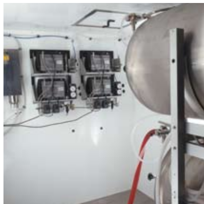
Kompressorer installeret i forbindelse med fadølsanlæg
